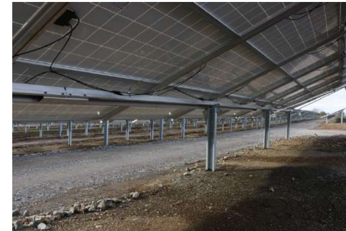
Figure 76 : Exemple de pistes empierrées - QENERGY
