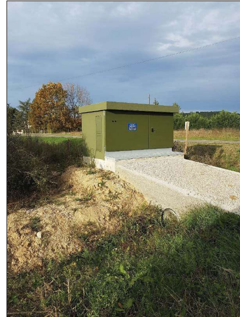
Figure 27 : Exemple de poste électrique surélevé à proximité du site étudié, dans la zone rouge du PPRi – Source : IDE Environnement
