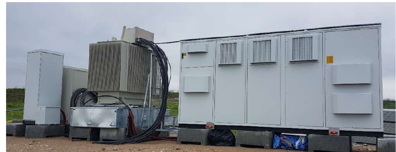
Figure 73 : Exemple d'onduleurs et transformateur installés à l'extérieur
