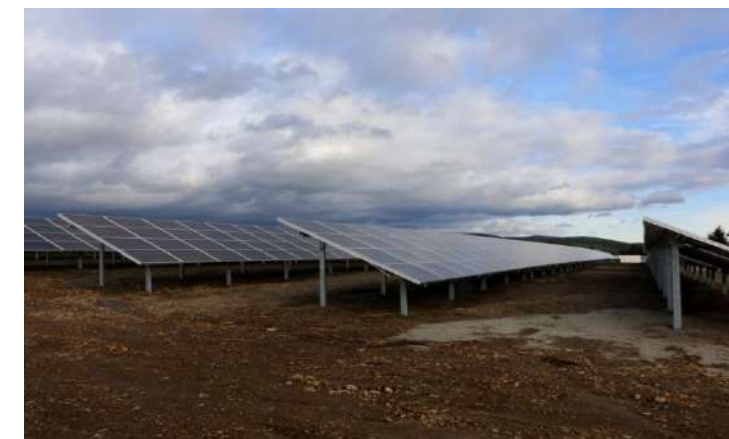
Figure 77 : Exemple d'espace non empierré entre tables - QENERGY
