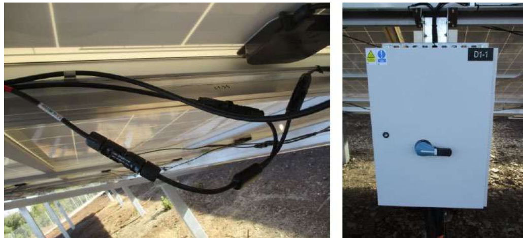
Figure 75 : Exemple de câble électrique et de boîte de raccordement - QENERGY
